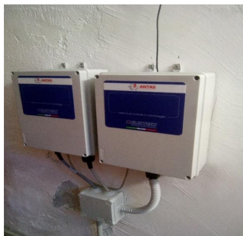
Figura 4.7 – Centralina di comando e telegestione della scuola
