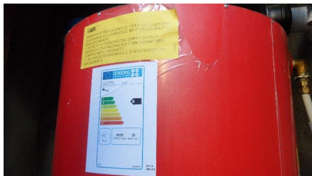
Figura 4.11 - Particolare bollitore ACS cucina
