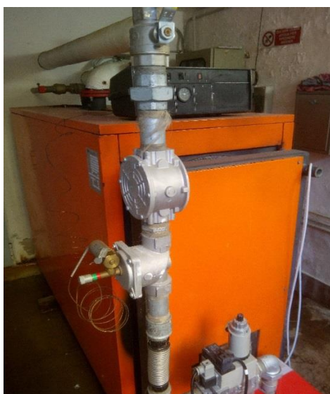
Figura 4.10 – Centrale Termica - Particolare del generatore di calore a basemento
